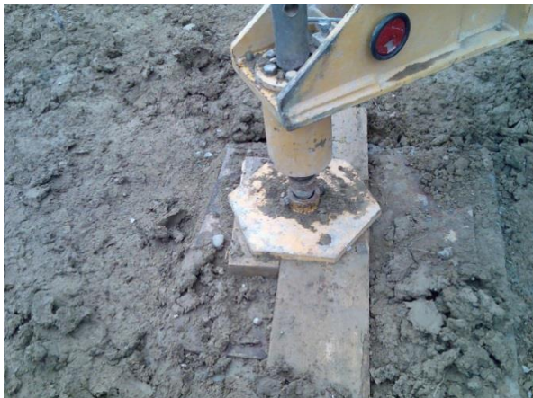
Folosirea necorespunzătoare a plăcii de lemn sub talpa de calare
