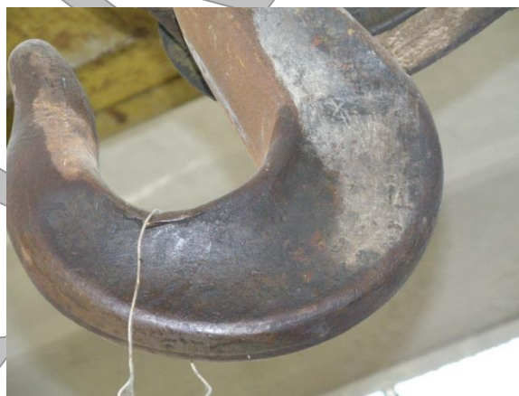
Uzură la șaua cârligului
