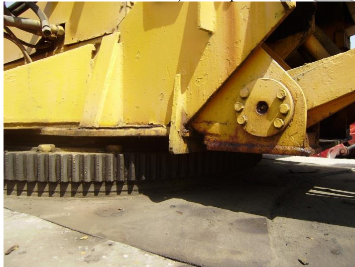
Uzură platformă rotitoare
