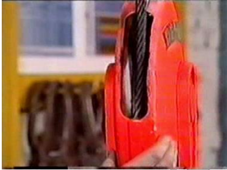
Verificarea cablului de sarcină și a rolei de cablu din muflă
