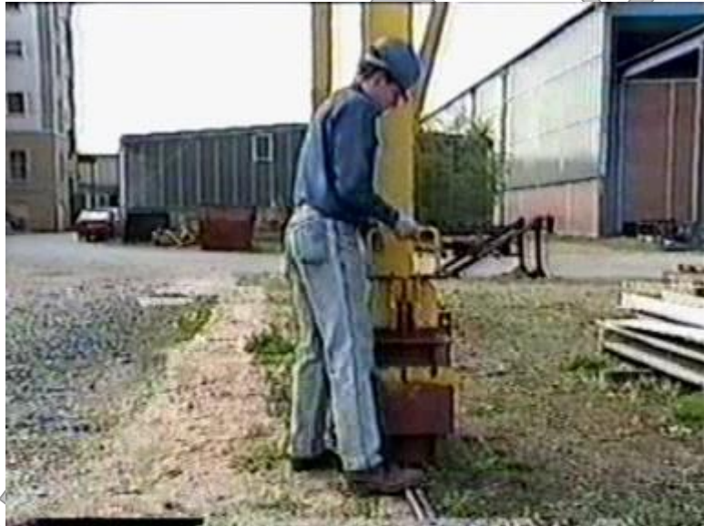
Deblocarea de la capătul căii de rulare
