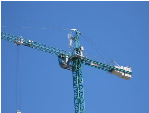
Macara turn cu comandă din cabină
